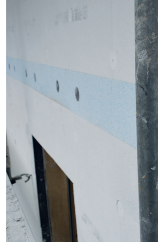
Vue de l'élément coupe-feu intégré en façade.
